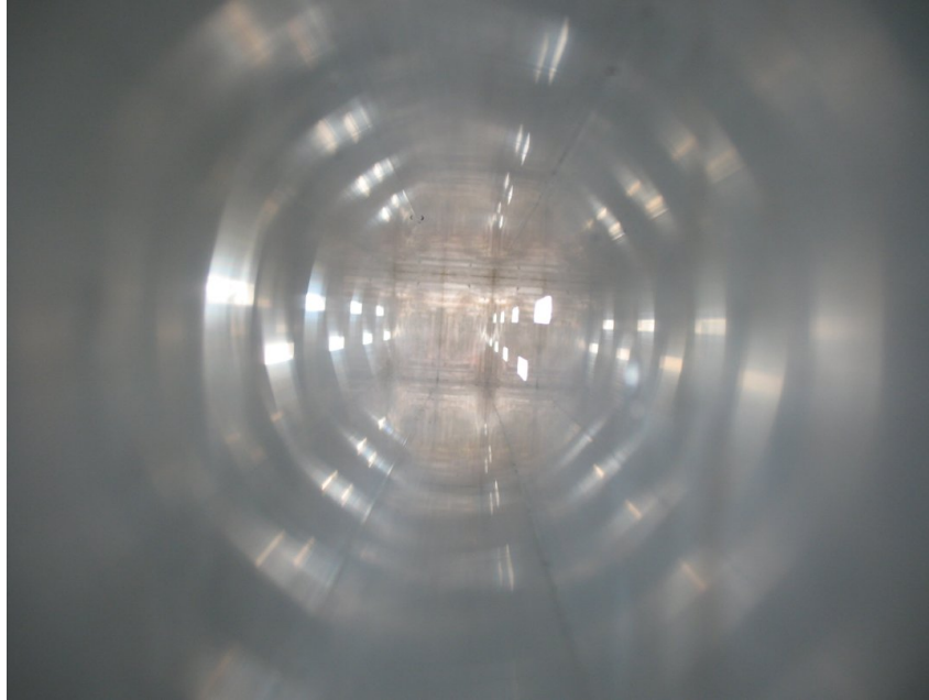
Slika 2.12: Pogled v notranjost antene.
